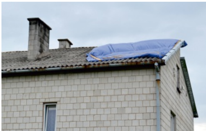
Zniszczony dach w Chełmcach Zamokradłu.
